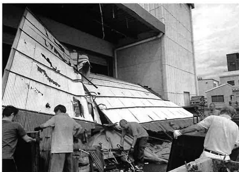
外壁が破壊された被害
