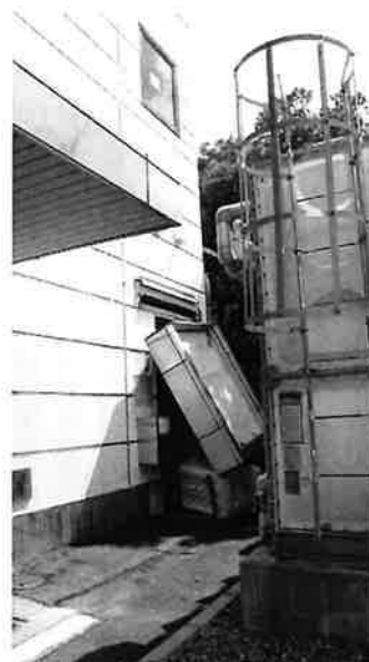
軒天が倒壊した被害
