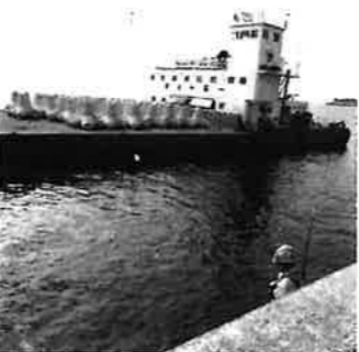
台風に備える幸浦護岸工事(消波ブロックの設置状況・6月3日撮影)
