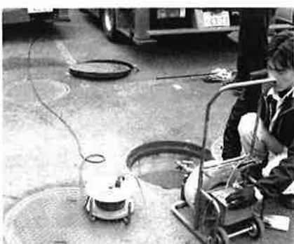
汚水管トラブルの原因を調べると……
